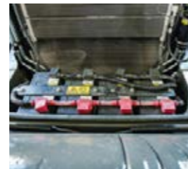
□ Quatre batteries sans entretien fournissent l'alimentation nécessaire au Fendt 1100 MT.
