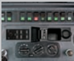
Panel de conmutación
