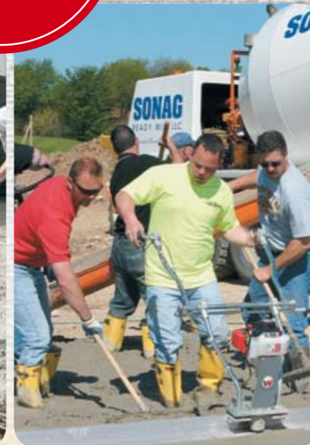
Fase 7: Con la staggia vibrante è possibile garantire che la superficie in calcestruzzo sia piana e che l'altezza richiesta venga mantenuta. In questo modo il terreno viene preparato in modo perfetto per l'impiego della livellatrice.
